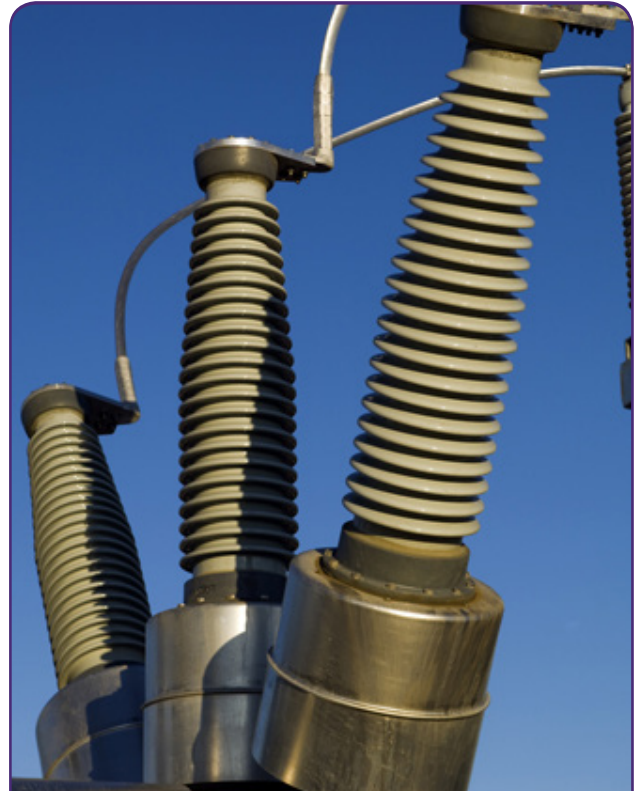
Жоғары кернеулі трансформаторлар
